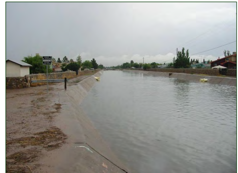
Mesa drain at Bordeaux.
